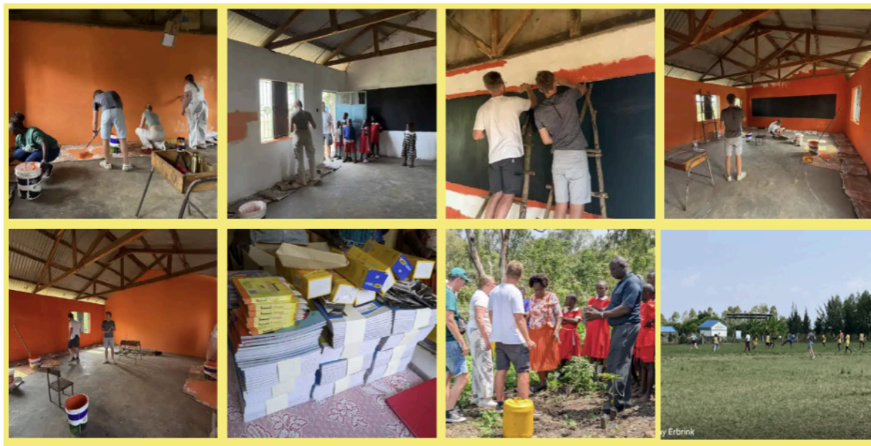
3 vloeren vervangen, 3 klaslokalen geleverd, schoolmaterialen geleverd en 3 bomen geplant bij Oyiengo
